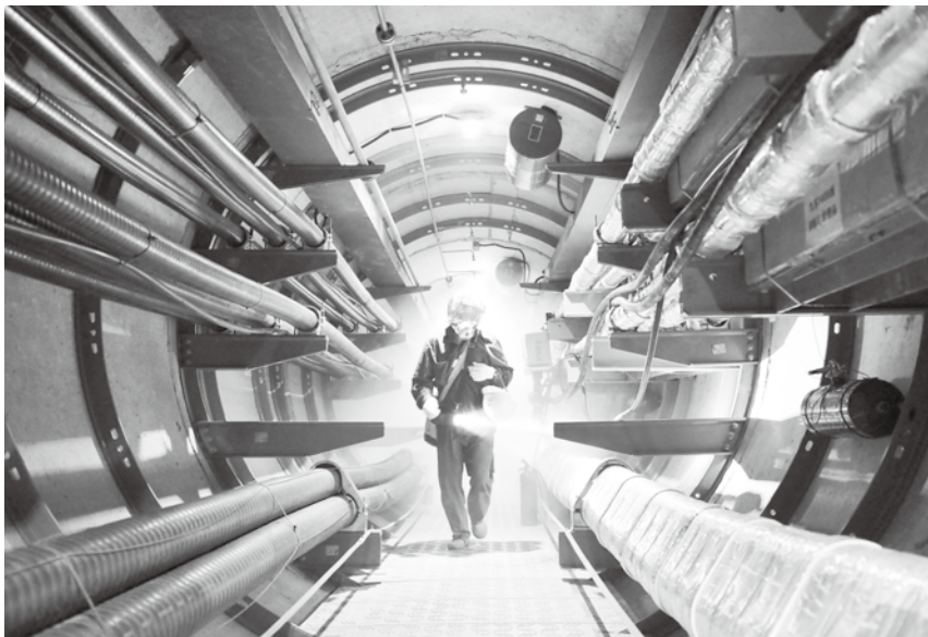
电缆隧道高压细水雾消防系统投入运行。
